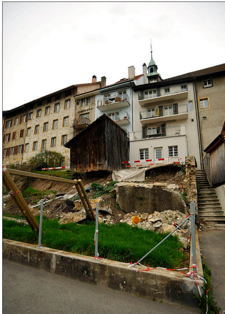
Das Wasser hat sich schon lange zurückgezogen, die Schäden am Salzhüslweg in Olten sind noch gut sichtbar.
